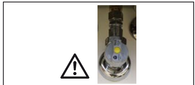
Bild: Gasanschluss Gefahr von Vergiftung und Explosion durch ausströmendes Gas
